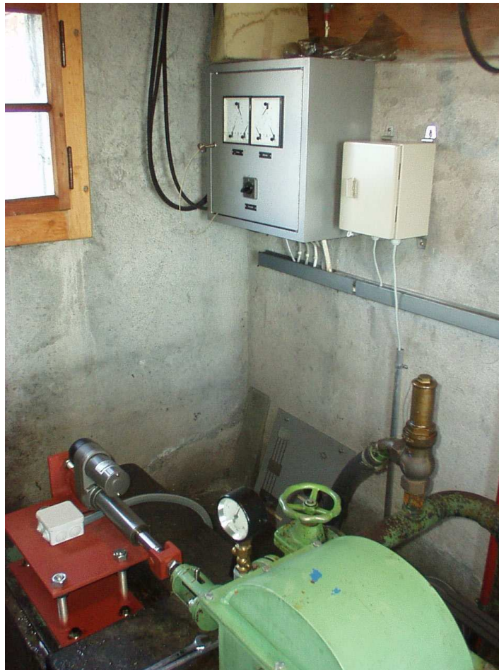
Regler im Kasten neben dem Schaltschrank
